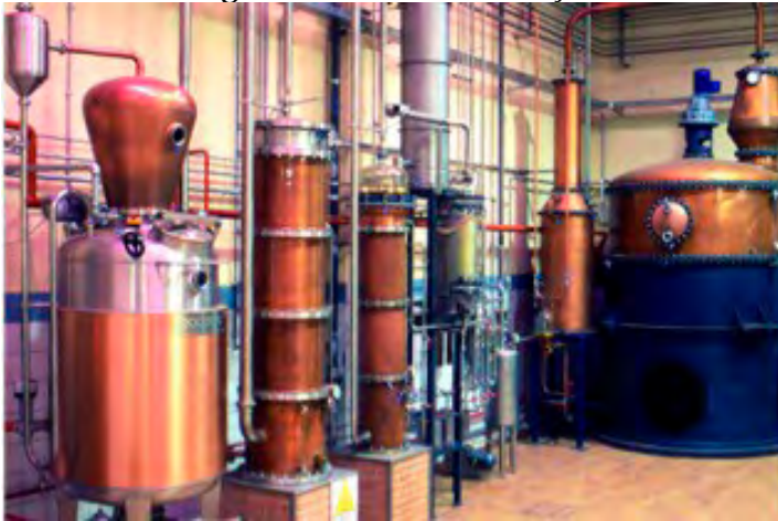
Figura 2 – Sala de destilação
